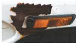
Obr. č. 1. Koroze kolem pozičního světla, na PP blatníku
